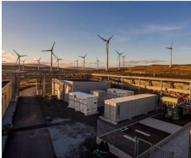
Pierwszy w Europie całkowicie litowo-jonowy, komercyjny system magazynowania energii (ESS) współdziałający z farmą wiatrową na Wyspach Owczych. Skonteneryzowane rozwiązanie o mocy 2,3 MW wspomaga utrzymanie stabilności sieci, dzięki czemu mieszkańcy wysp mogą w pełni wykorzystywać 12 MW potencjał farmy wiatrowej Húsahagi. Źródło: SEV
